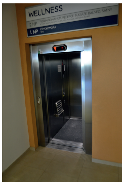
Kabina výtahu se sedátkem
